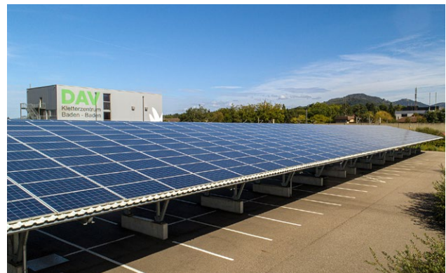
Abbildung 7: Stellplatzüberdachung mit geschlossenem Blechdach, auf dem Standardmodule montiert sind.
