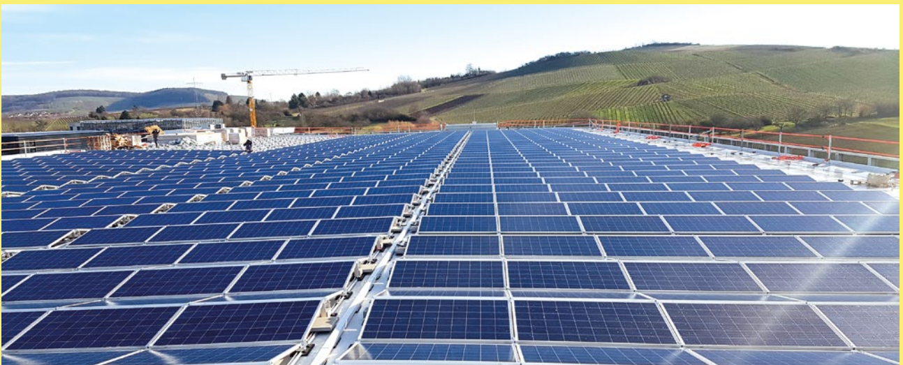
Parkhaus in Neckarsulm produziert Sonnenstrom: Das Dach ist vollständig mit Photovoltaik belegt. Knapp 2000 Module liefern eine Leistung von 520 kWp. Quelle: Orange Solar GmbH
