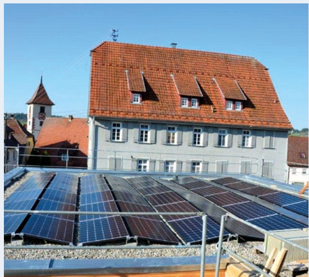
Der Kindergarten in Ebhausen produziert und nutzt seit 2019 seinen eigenen Sonnenstrom. Quelle: Gemeinde Ebhausen
