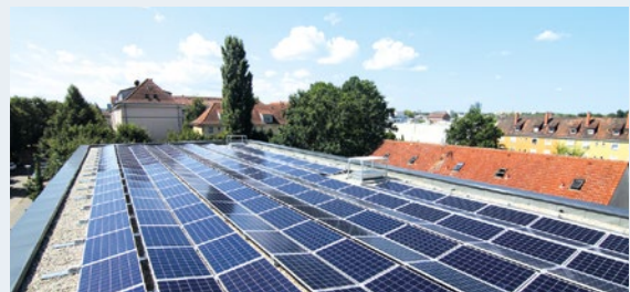
Die 99 kW-Photovoltaikanlage auf dem Dach liefert den Strom direkt an die Probühne des städtischen Theaters.
