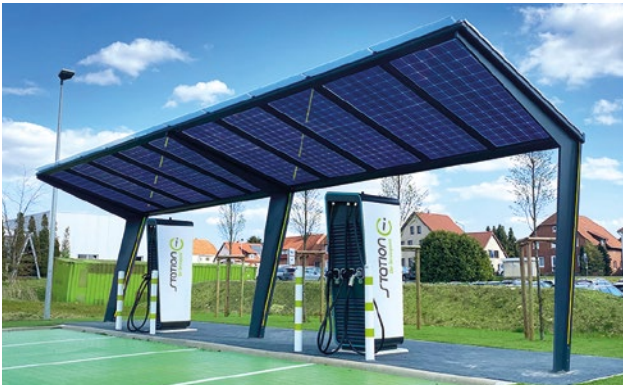
Mobilitätsstation mit Zusatzservices: Lädt E-Autos und verbindet das mit Solarstrom, Informationsdisplay für Bürger, Paketstation, Getränkeautomat, LED-Beleuchtung, Sitzbank, W-LAN Hotspot, usw. – je nach Bedarf.
