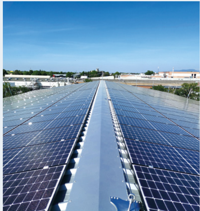
Solarmodule, soweit das Auge reicht: Schwarzwald Eisen erzeugt und verbraucht grünen Strom vom eigenen Dach.
